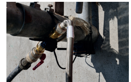
Capteur de débit connecté (réseau LoRawan) de l'abreuvoir bovin
